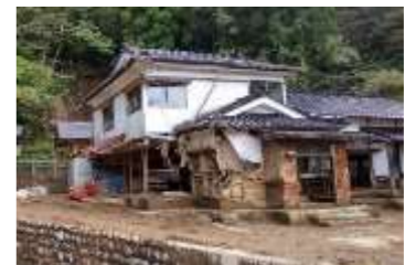
土砂による被害が大きく被災から約3ヵ月経った今もニーズが継続されている北青沢地区の状況。川には山から流れてきた流木が撤去されずに残っています。
